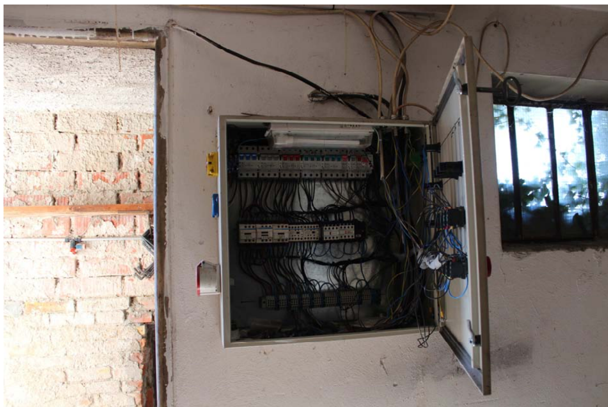
Rozvaděč v dílně (1.PP)
