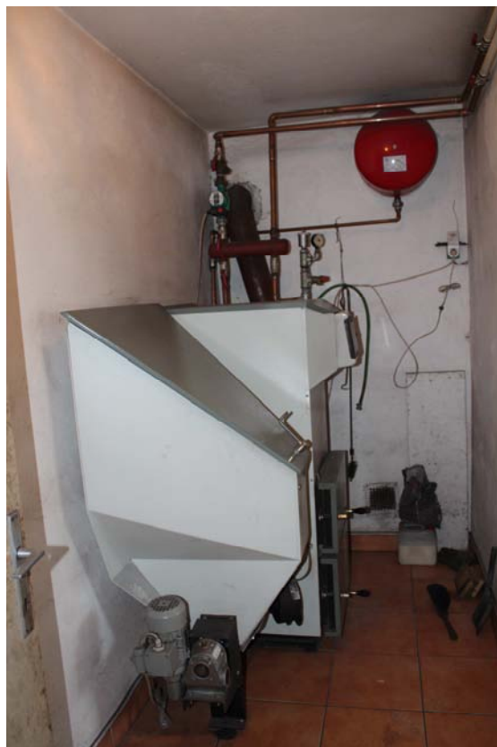
Bojler pod schodiště , kotelna (1.PP)
