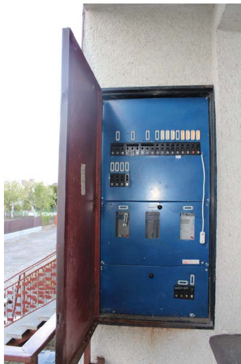
Hlavní rozvaděč elektro v závětrí
