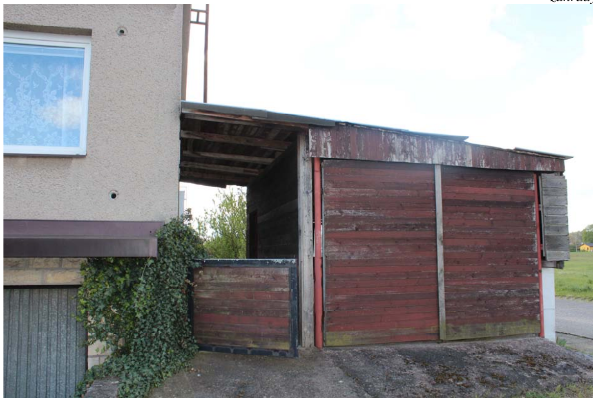
Přístřešek – černá stavba
