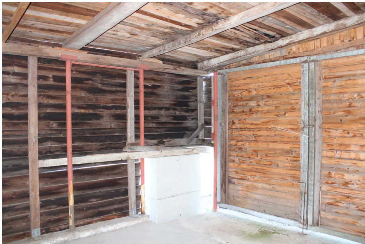
Přístřešek – černá stavba
