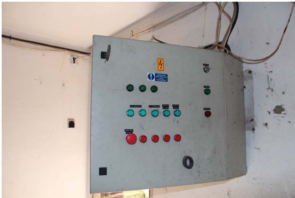
Rozvaděč v dílně (1.PP)
